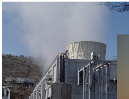
Geothermal plant in Kyushu with the biggest capacity in Japan 日本最大の発電能力を有する九州の地熱発電所
